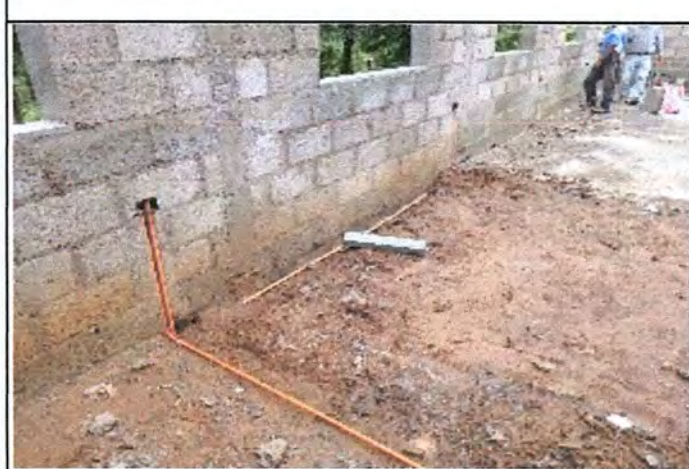
Foto 4: AULA TIPO PORTICO-SISTEMA ELECTRICO
